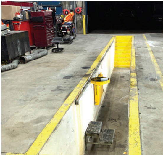
Photo 13 : Exemple de fosse d'inspection fonctionnelle (atelier de Gatineau)
