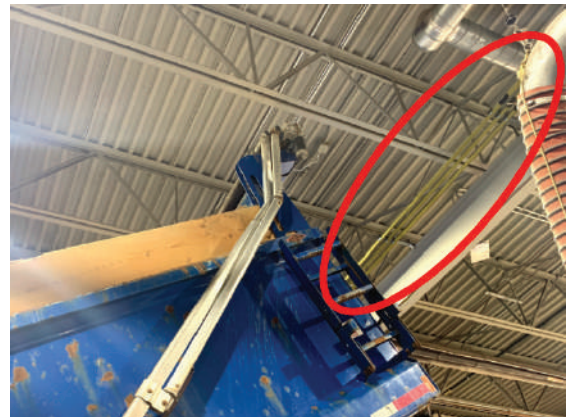
Photo 20 : Plafond limité en hauteur : risque d'accrocher certains éléments structuraux – l'ovale rouge indique des lignes de tension de 600 volts (atelier de BMA)
