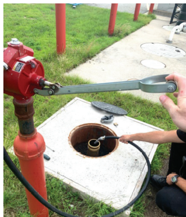
Photo 2 : Pompe manuelle dont la sécurisation a été contournée avec un tournevis
