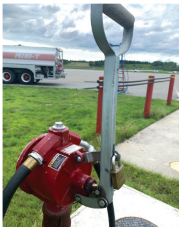
Photo 1 : Pompe manuelle sécurisée avec un cadenas, mais dont la fermeture est soutenue par une vis
