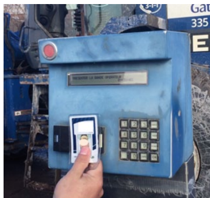
Photo 1 : Système de contrôle d'accès activé par une carte à puce autorisée
