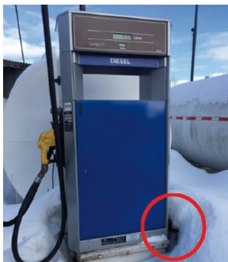
Photo 2 : Extincteur présent, mais peu visible
